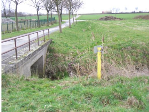
Düker der Gasleitung für Mahlum
