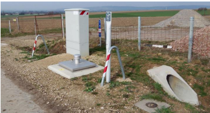
Übergabestation aus der Grane-Leitung für Mahlum und für die Stadt Bockenem
