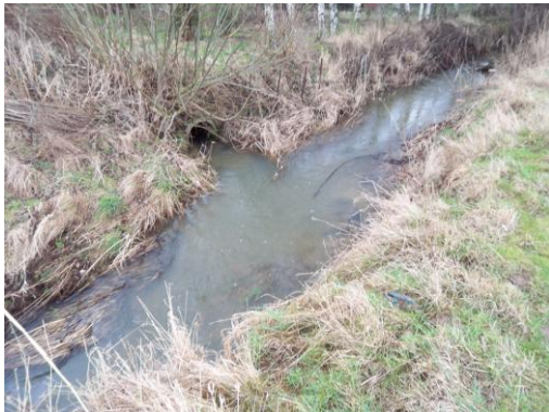
Regenwasserkanal bei König / Pook
