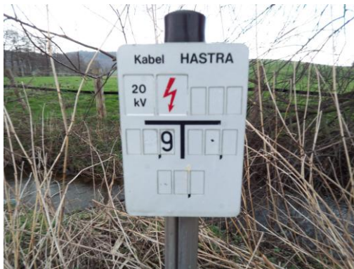
Düker für die 20 kV – Leitung am Bachweg
