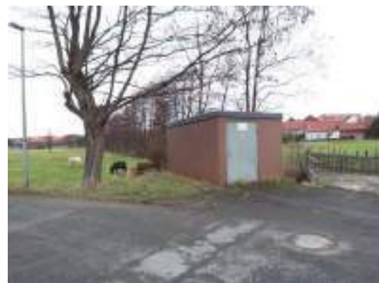
Trafostation rechts die Brücke
